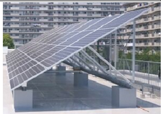
アキシマエンシス（教育福祉総合センター）の太陽光発電システム
