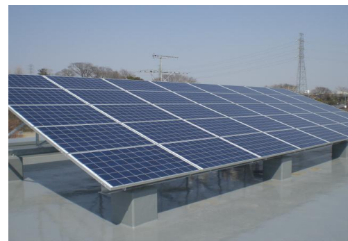
共成小学校の太陽光発電システム
