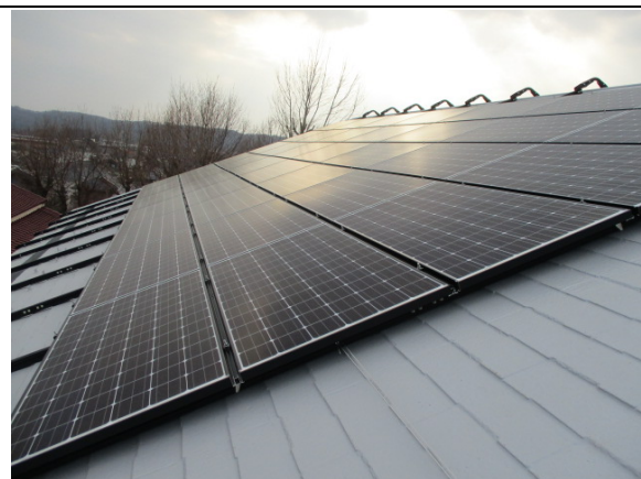
緑会館の太陽光発電システム
