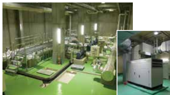
写真はポンプ室(上)と発電機(右)
