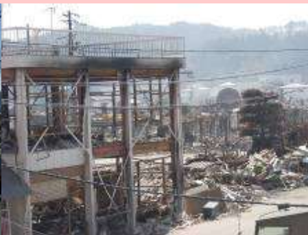
鉄筋の建物が崩れずに残っていたが、焦げており、火事が起きたことがわかる (山田町役場付近)
