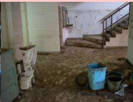
小本支所内 壁に泥がついている高さまで 津波が押し寄せた (小本地区)
