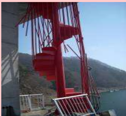
水門の上 津波により階段が壊れている (小本漁港)
