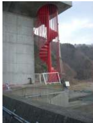
歪んだ非常階段手すり
