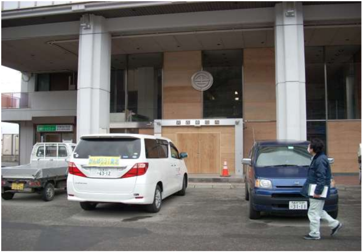
被災した宮古市役所正面玄関（1・2階が津波により全て流された）
