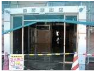
〈1階が浸水した宮古市役所〉
