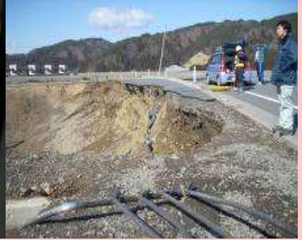
防潮堤及び道路が津波で崩れている (小本地区海岸)
