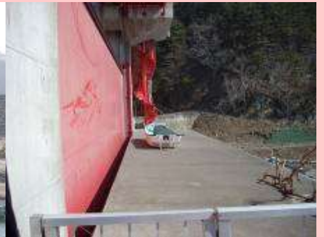
左の写真に写っている水門の上 高さ12メートルだが、船が打ち 上げられていた。津波の高さを物 語っている。
