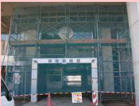
1階部分は危険なので、バリケードで入れないようにしている (宮古市役所)
