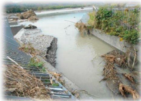
令和元年東日本台風による被害 (昭和用水堰)
