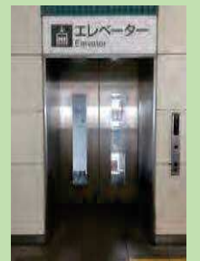
エレベーター
