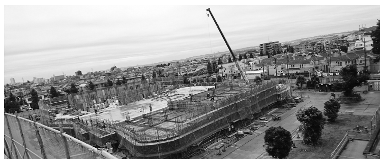
(工事近況写真 8月20日撮影) 2階床3分の2ほどのコンクリート工事が完了しました。
